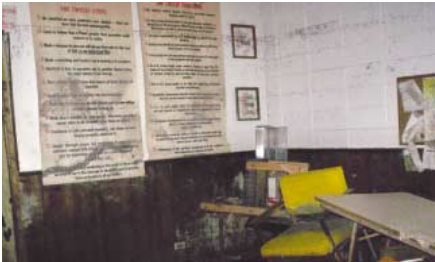
En esta sala de Chalmette, Louisiana, donde se reunían los grupos de A.A. tales como “Ladies Night” y “Arabi We Share” se pueden ver los efectos de la inundación que sufrió el área después del Huracán Katrina. Muy arriba en la pared y en los carteles de Doce y Doce—justo debajo del Primer Paso—se puede ver la marca que indica hasta donde llegaron las aguas.
